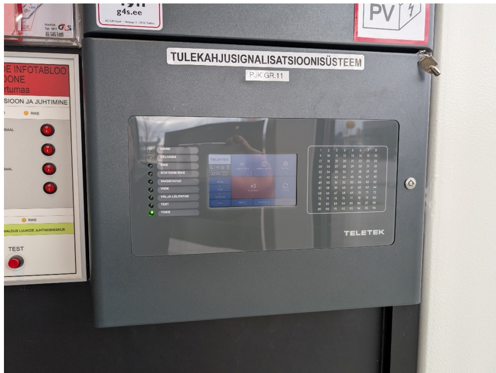
Foto. Hoone ATS keskseade.
